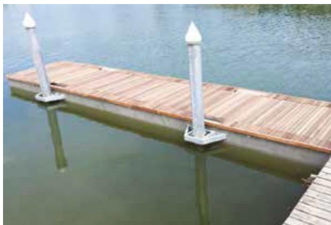
Figura 21: molo galleggiante con colonne per l'ormeggio latero-laterale dell'imbarcazione
